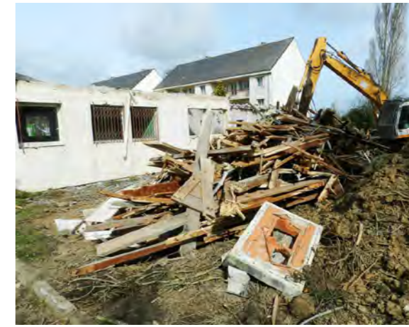
Lamballe (22) – ZAC du Liffré, démolition de la gendarmerie Crédit photo : EPF Bretagne
